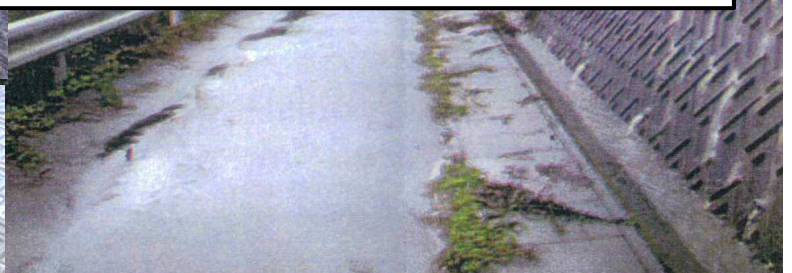
水路断面の縮小、湧水
